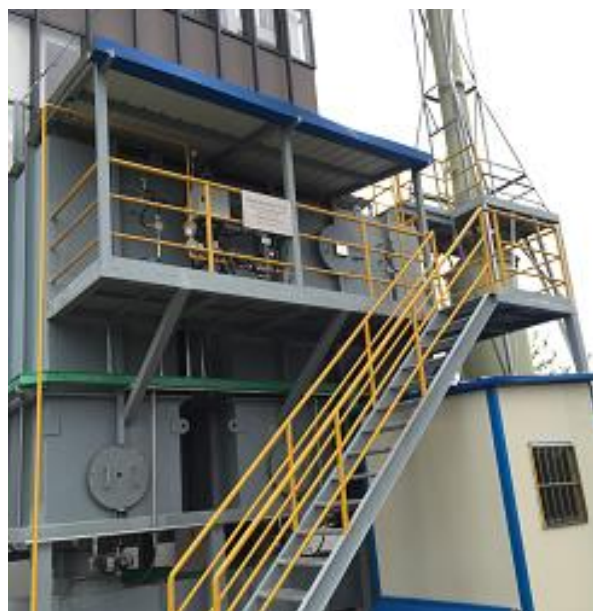
RTO 焚烧设备
